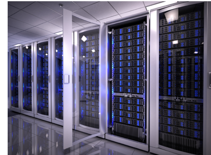
Server im Rechenzentrum
